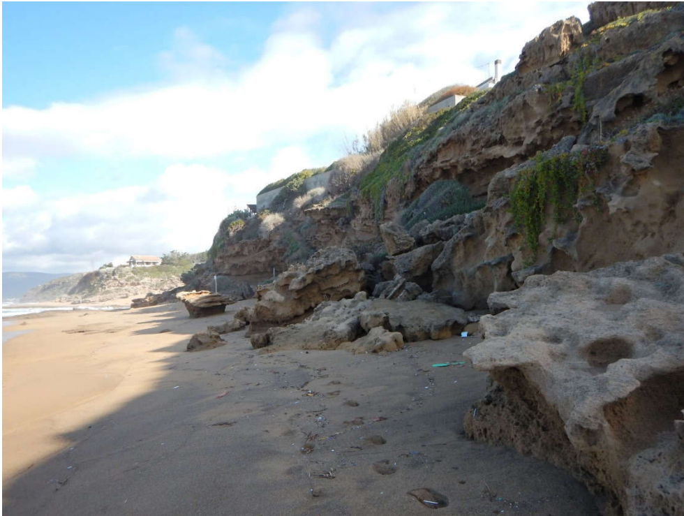
Figura 7-11 – Falesia tra Porto Alabe e Noesola, tutto il settore è interessato da dissesti diffusi che hanno interessato e stanno coinvolgendo, per il continuo arretramento, le opere antropiche in parte crollate sulla spiaggia.
