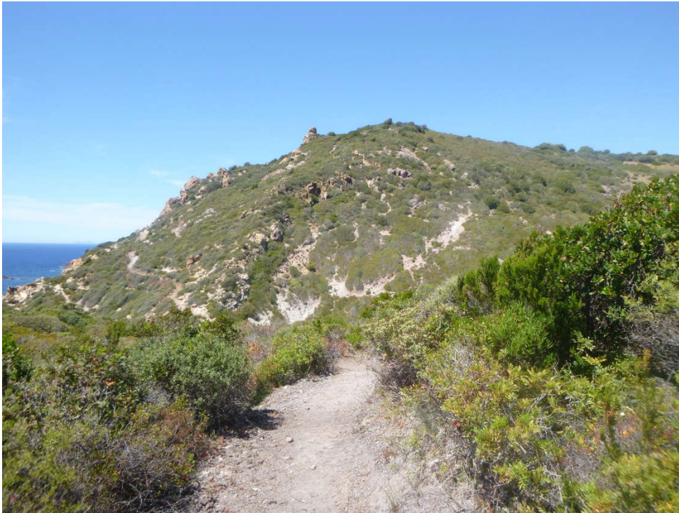
Figura 7-7 – La cresta rocciosa conformata su piroclastiti saldate in rilievo, presenta ammassi rocciosi molto fratturati in condizioni instabili e di incipiente movimento con potenziali cinematismi di crollo e ribaltamento e successivo rotolamento lungo i pendii dove possono riconoscersi i blocchi, i massi e i megablocchi rotolati, nel settore a valle della cresta si osservano invece le rocce tufacee che sono maggiormente interessate da fenomeni di erosione e movimenti in massa connessi all'azione del deflusso delle acque.
