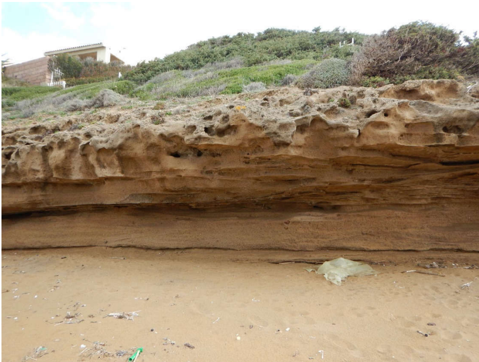
Figura 7-12 – Morfologie a mensola ed erosione differenziale nella ripa di erosione marina nel retrospiaggia di Porto Alabe, la ripa è in continua evoluzione, infatti alla base agisce l'azione demolitrice del moto ondoso che conforma una morfologia a sbalzo predisposta a fenomeni di crollo.
